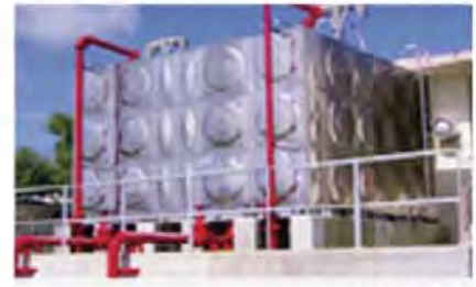
パネルタンク
