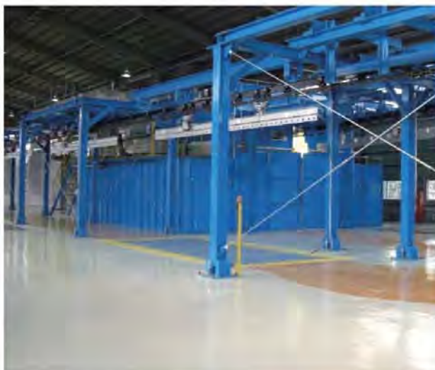
塗装ライン外観
