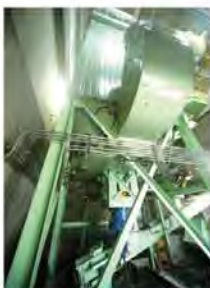
ごみ焼却炉 設備
