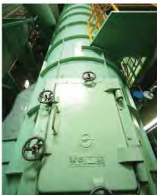
ごみ焼却炉 設備
