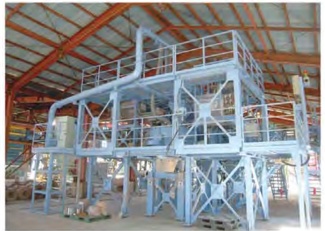
レジン製造設備
