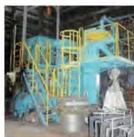
廃棄砂再生設備
