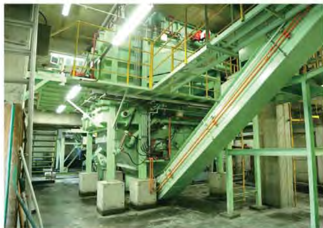
ごみ焼却炉 設備
