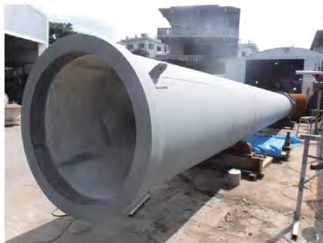
ボイラー煙突
