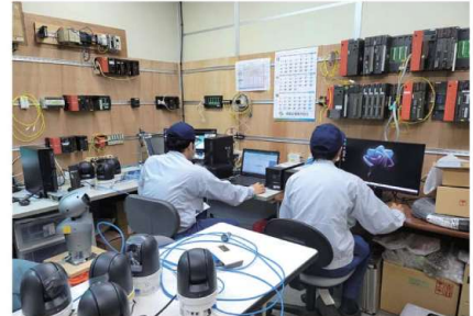
監視制御システム構築
