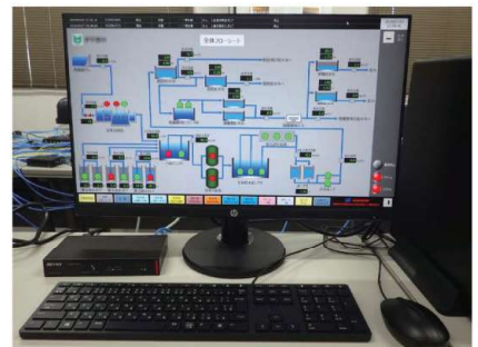
プラント監視制御システム
