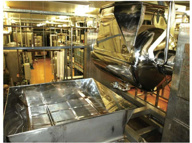
原料抽出工程
