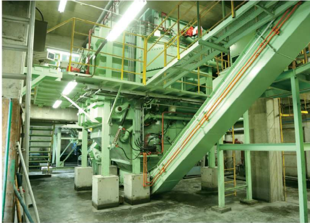
ごみ焼却炉 設備
