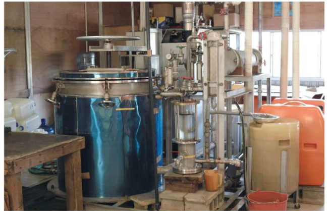
【水蒸気蒸留装置】
