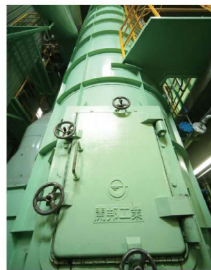
ごみ焼却炉 設備
