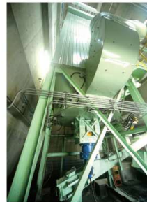
ごみ焼却炉 設備
