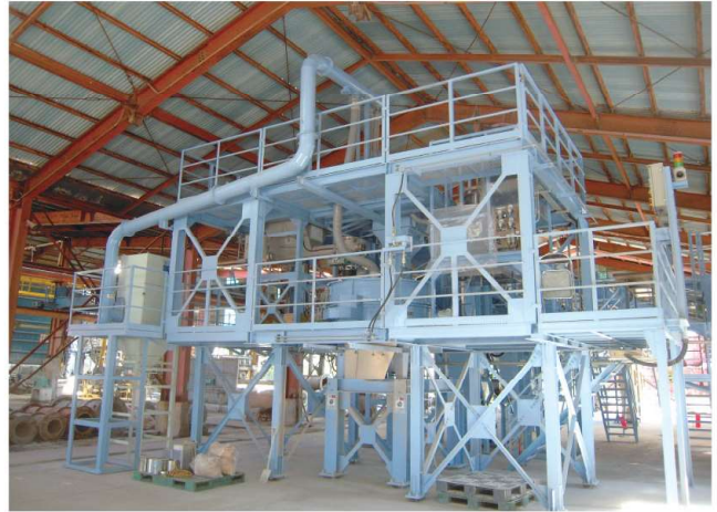
レジン製造設備
