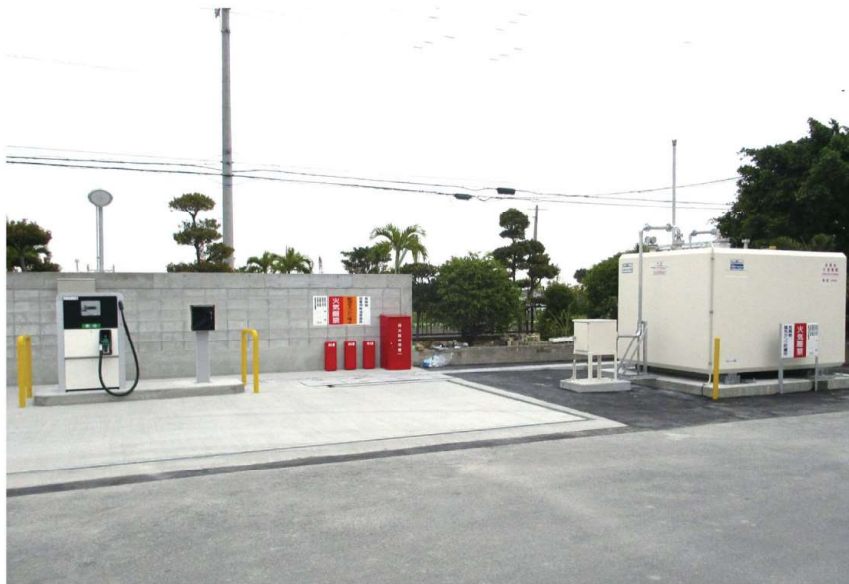
国内初の屋外燃料貯蔵タンクを使用した自家用給油取扱所
