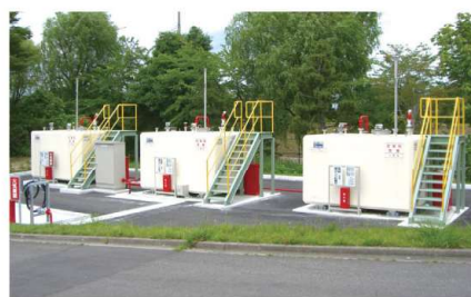
コンボルト型タンクの外観
