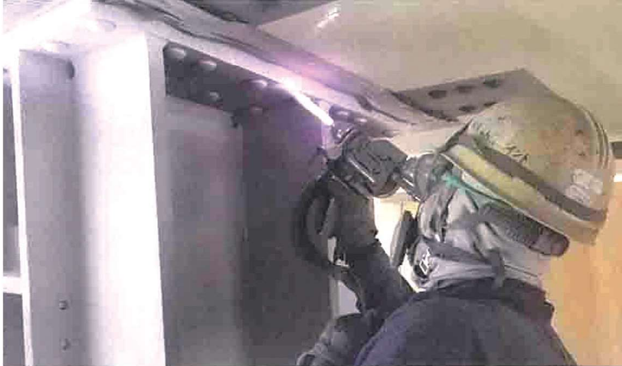
落橋防止装置への金属溶射 (アルミ・マグネシウム合金)
