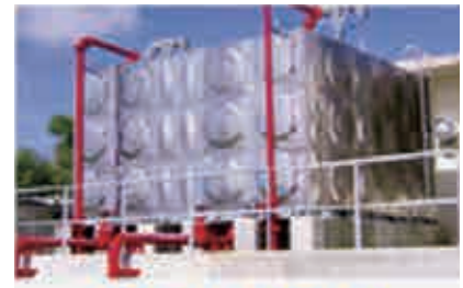
パネルタンク
