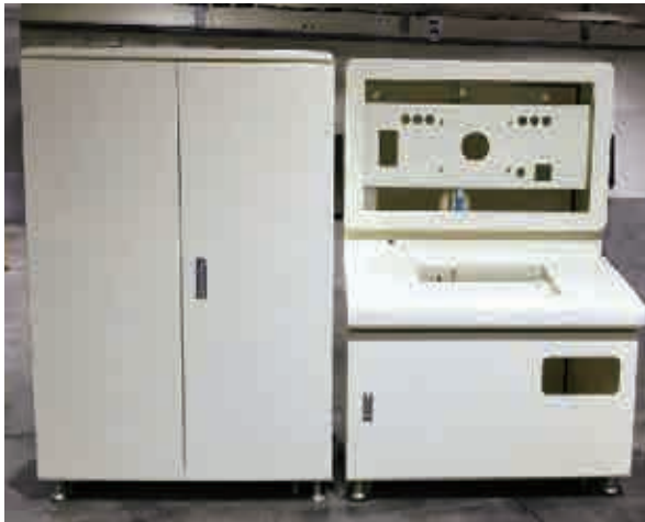
装置-制御盤A
