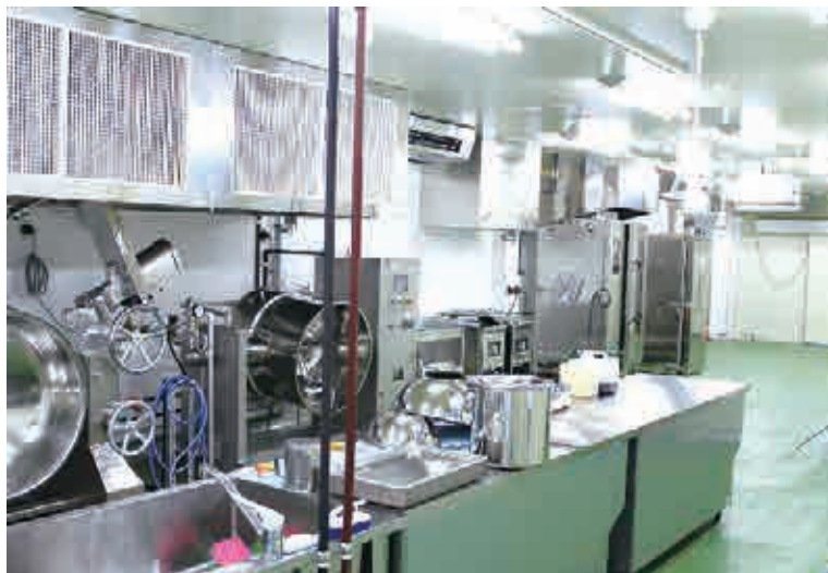
蒸気釜やスチームコンベクションにより、煮る、炒める、焼くなどの加工ができます。
