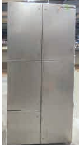
ステンレス製制御盤
