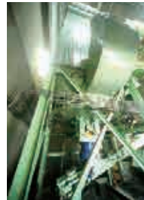
ごみ焼却炉 設備
