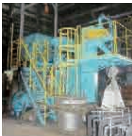
廃棄砂再生設備
