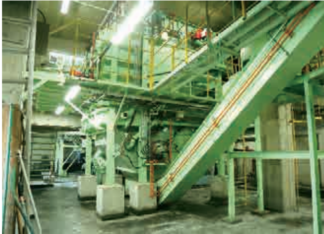
ごみ焼却炉 設備
