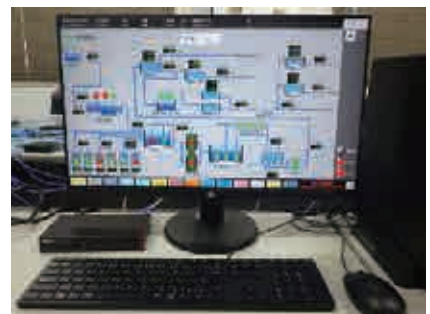
プラント監視制御システム
