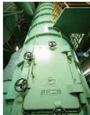
ごみ焼却炉 設備
