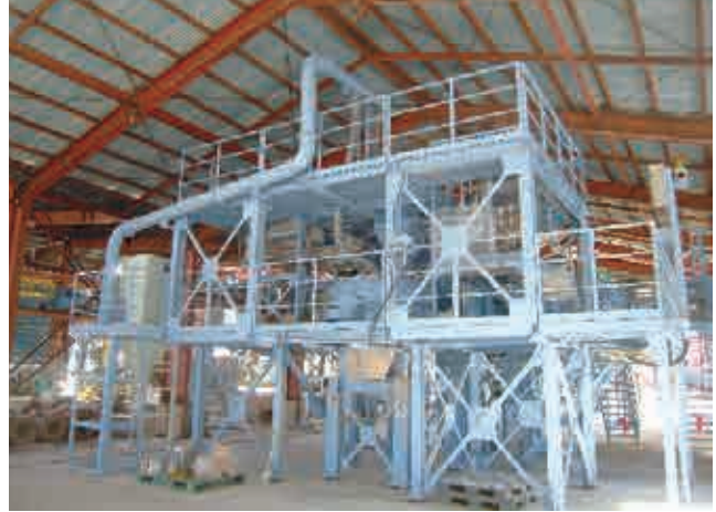
レジン製造設備
