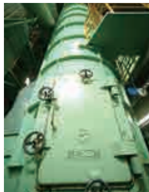
ごみ焼却炉 設備
