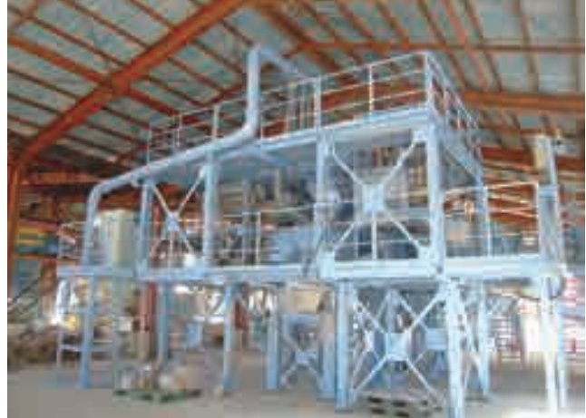
レジン製造設備
