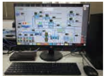
プラント監視制御システム
