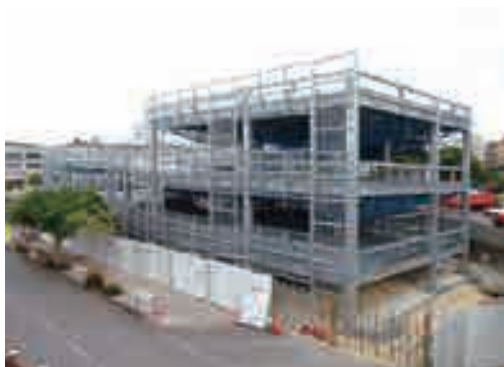
納入実績：那覇市内立体駐車場
