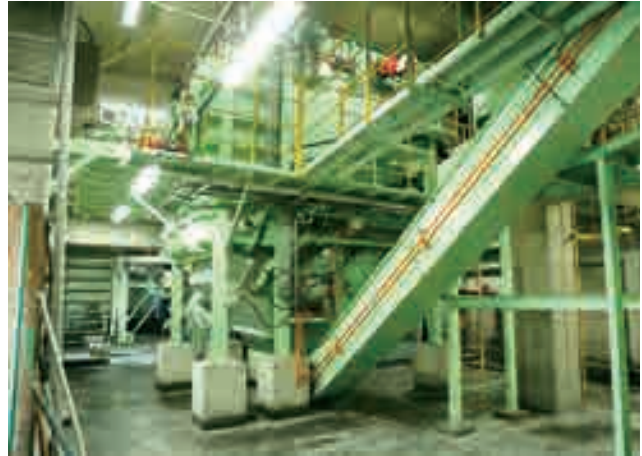
ごみ焼却炉 設備
