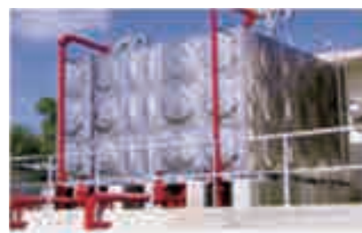
パネルタンク
