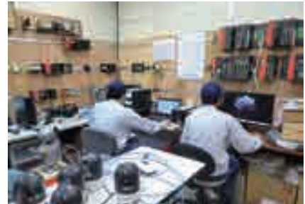
監視制御システム構築
